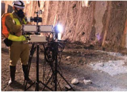
写真-1 切羽撮影専用照明
