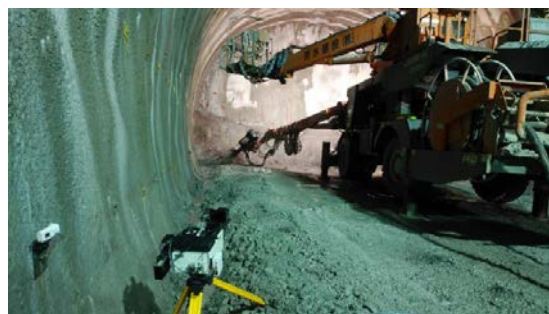
図-1 システム設置状況
