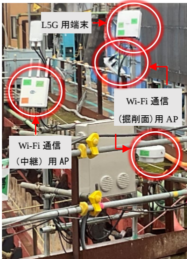
図-4 中継地点設置機器 (中継地点 E)
