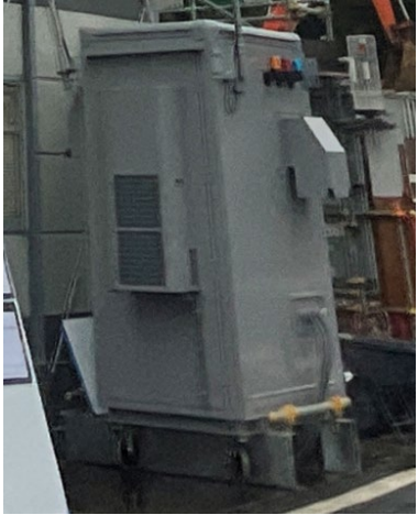
図-3 設備収納 BOX
