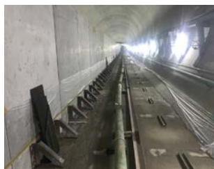
写真-2 配管蛇行
