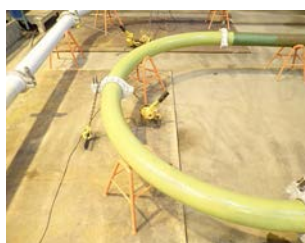
写真-3 配管振れ防止
