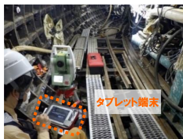
写真-1 シールド坑内自動測量システム運用状況
