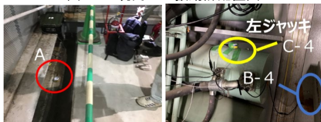
図-3 振動計の設置状況
