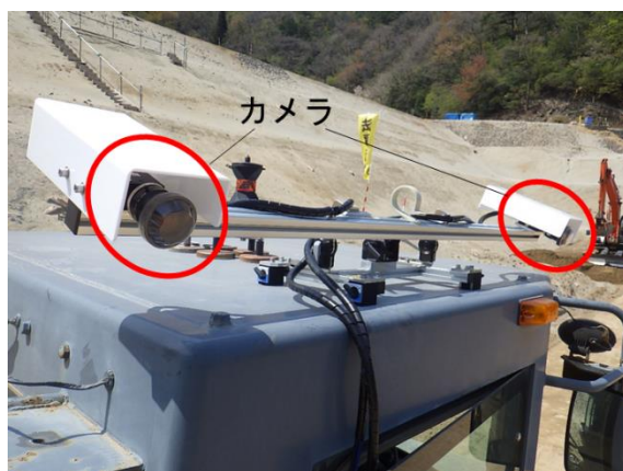
写真-1 ステレオカメラ設置状況
