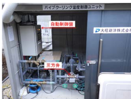
写真－2 パイプクーリングユニット
