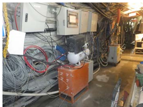
写真-2 操作盤・操作ユニット
