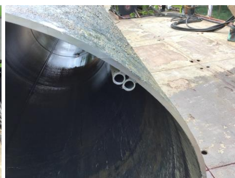
写真10 鋼管杭切断断面（拡大）
