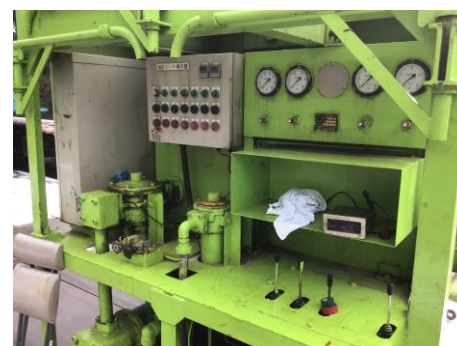
写真2 油圧ユニット操作盤
