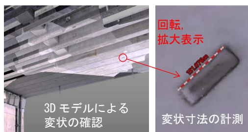
図-3 剥離・鉄筋露出の検出と寸法計測
