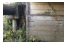
図4 下部構造の損傷写真
