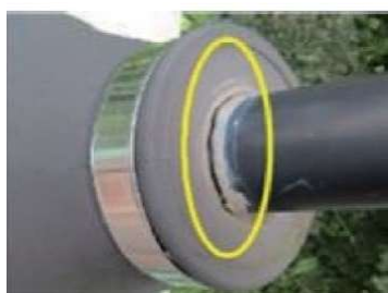
写真3 シーリング材の劣化 3)
