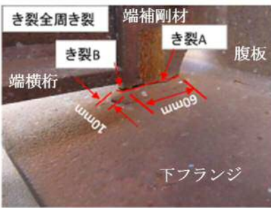
図3 端補剛材き裂発生状況
