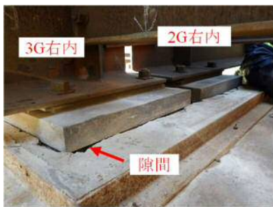
図4 沓座破損状況
