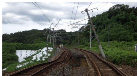
図-1 盛土崩壊時の様子
