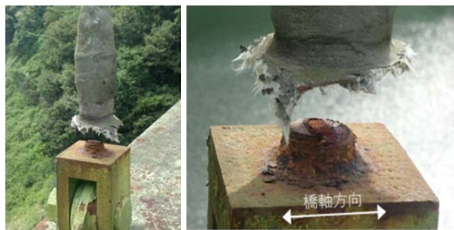
写真-1 ロッドタイプハンガー破断状況 (2021 年)
