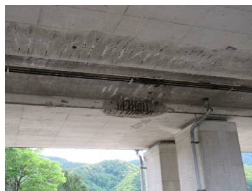
図-2 中空床版橋の桁部の損傷事例
