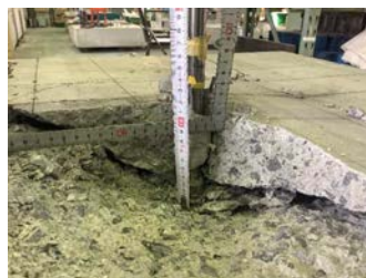
写真-3 コーン状破壊
