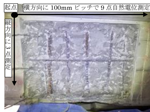
写真 2 鋼材腐食状況
