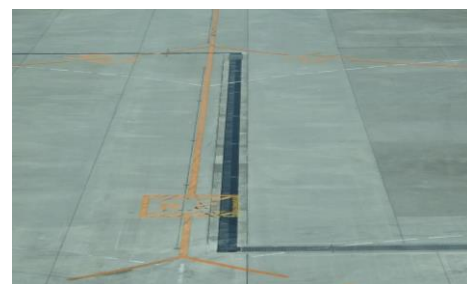
図-8 那覇空港設置写真
