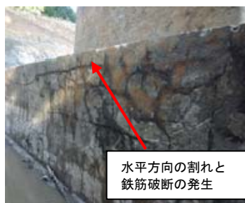
写真-1 ASRが発生したフー チングの状況 (能登有料道路)
