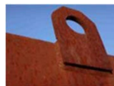
写真-1 全面腐食
