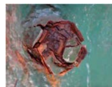
写真-2 局部腐食
