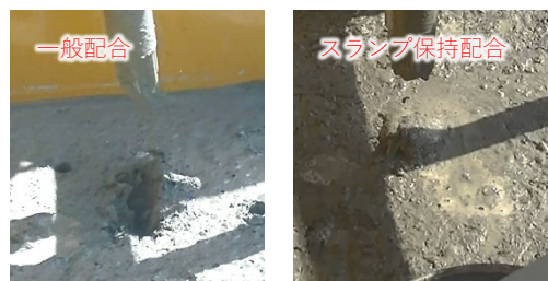
写真-1 バイブレータの引抜き跡
