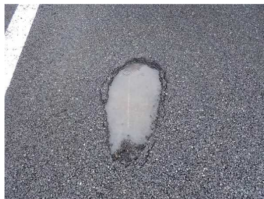
写真-1 ポットホール発生状況
