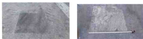
図-4 繊維シート剥がれ状況(1年経過後)
