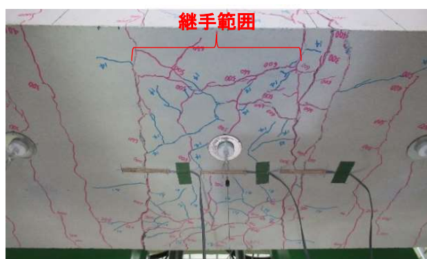
写真－4 試験体 3 下面（鉛直変位 14mm）
