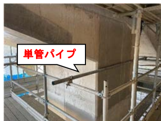
写真7 足場の倒壊対策
