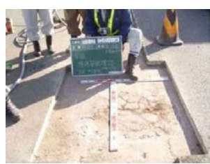
(b) ひび割れ発生状況
