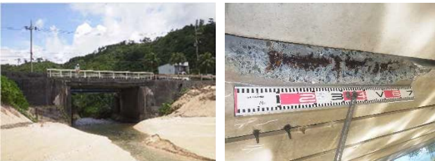
写真-1 対象橋梁外観・桁下損傷状況
