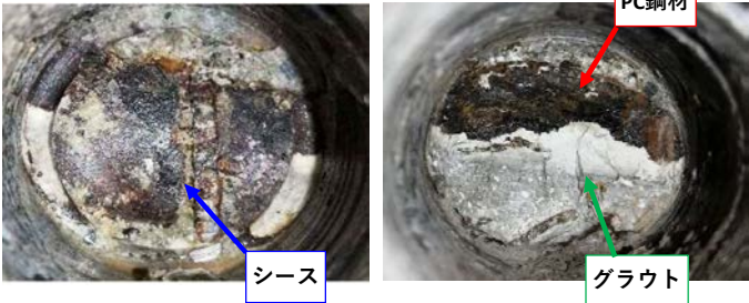
図-3 遊離石灰発生箇所における PC 鋼材内部状況
