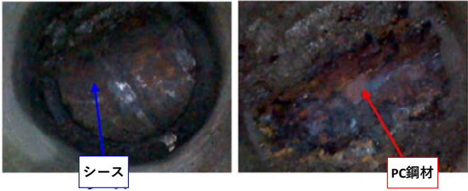
図-4 剥離発生箇所における PC 鋼材内部状況
