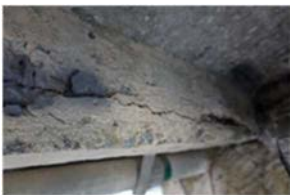
(a) 上部工の老朽化
