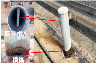
写真-1 橋梁部ガードレール損傷例
