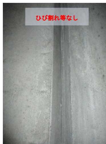
写真4 対策後の目地部
