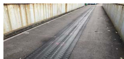
写真-4 路面状況(20万輪走行後)
