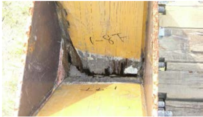
写真-2 トラス格点部の腐朽状態
