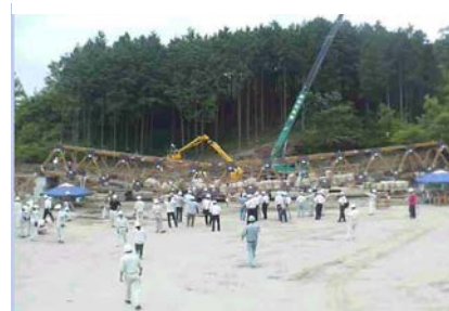
写真-4 二次破壊の状態
