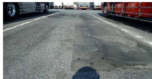
写真-1 駐車場舗装の路面変状
