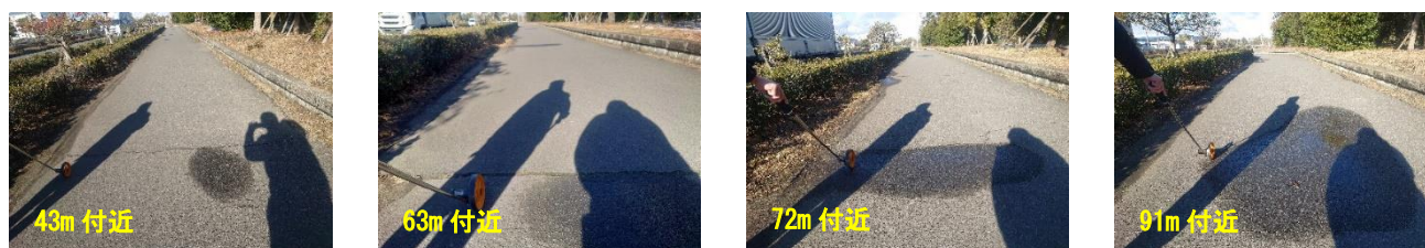
図-6 水溜まり発生状況
