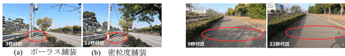
図-5 振動周波数が卓越した路面の状況
