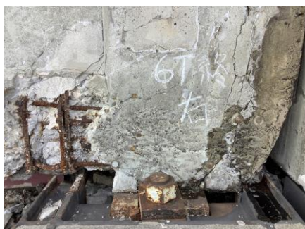
図-3 支承直上の桁の損傷
