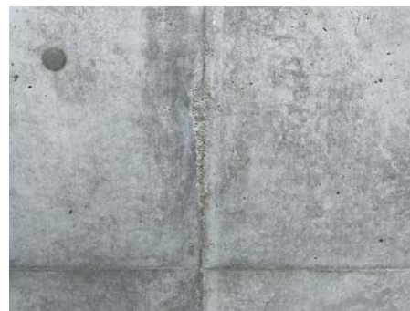
写真-1 砂すじ発生状況
