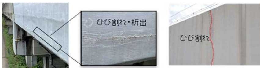
図 1. ひび割れ(左:地覆との境界部, 右:防音壁天端からのひび割れ)
