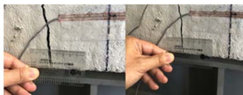
図-7 ひび割れ状況 (左: 無補強 右: 補強)
