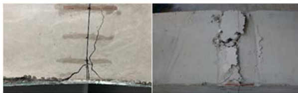
図-5 はく離の様子
