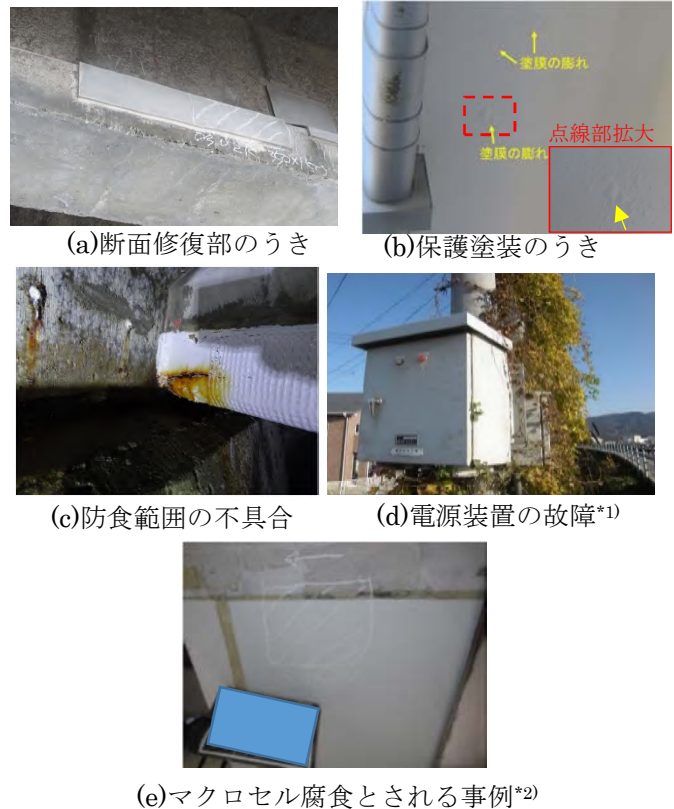
図-1 調査分析で確認した再劣化事例
