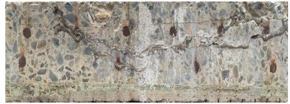
写真-1 供試体断面の損傷状況
