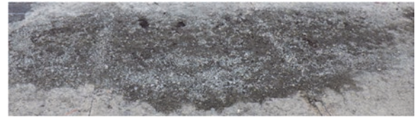
写真-1 RC 床版の土砂化
