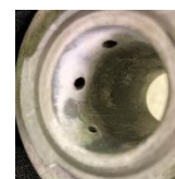
写真-4 急結剤添加部
