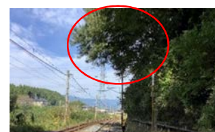
写真-4 電気設備への支障
