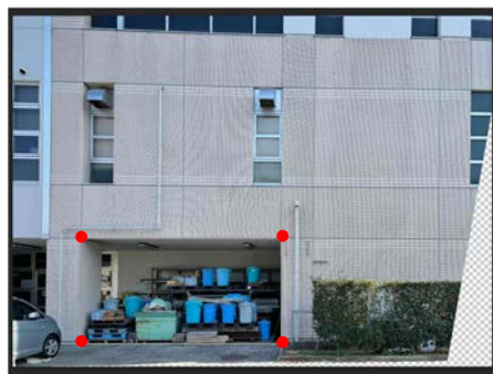
図-5 歪み補正した側面写真
