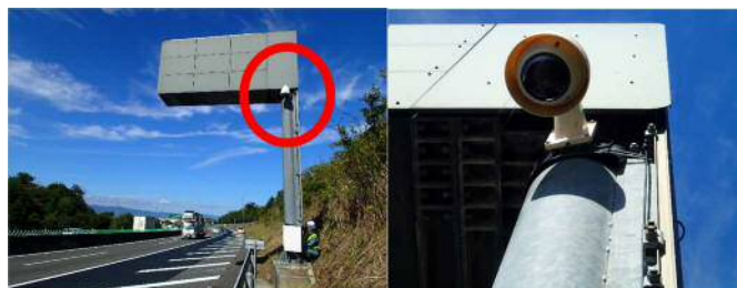
図 5. モニカメの設置状況（草津田上 IC A 型情報板添架）
