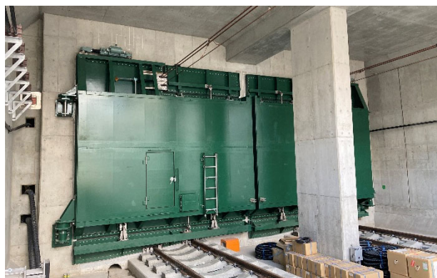
写真-1 起点方止水鉄扉
